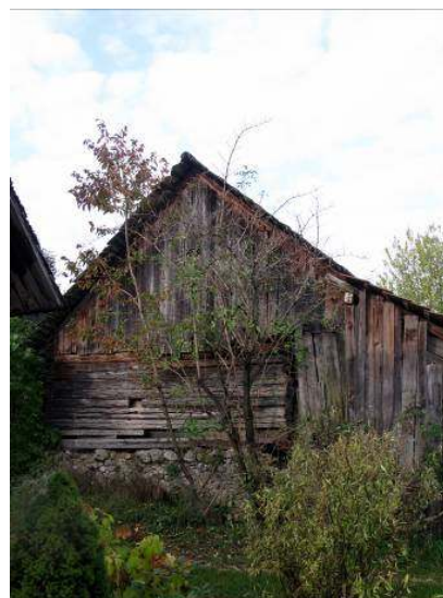
Pročelje razpadajoče Turkove domačije.
